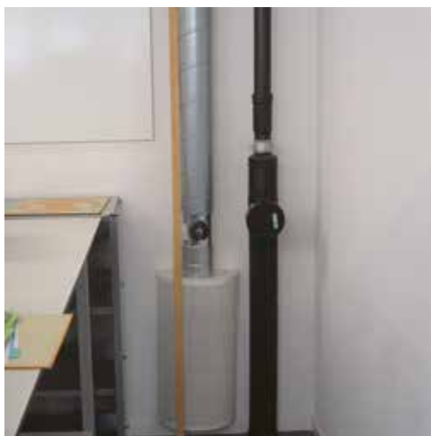
Figure 6.74: Bouche de sortie de la ventilation (à gauche), réglage du débit volumique de l'air évacué (à droite).
