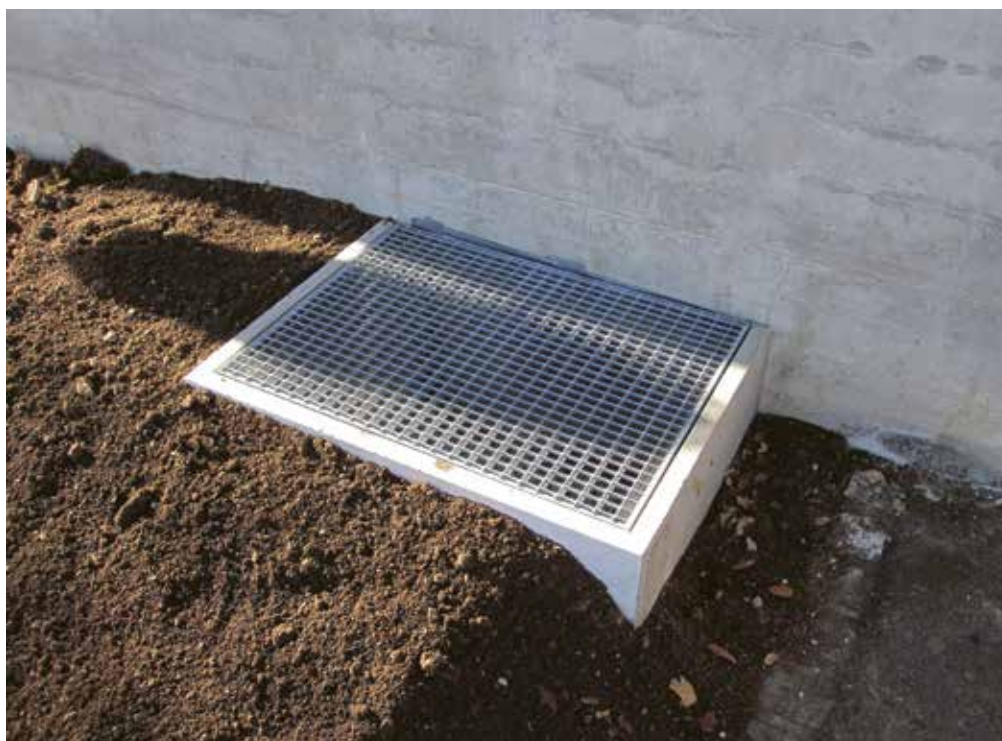
Figure 6.50 : Au lieu d'être évacué par une conduite menant jusqu'au toit, l'air s'éva- cue par cette grille. Près de celle-ci, la concentra- tion de radon est d'environ 4000 Bq/m 3 en période scolaire.
