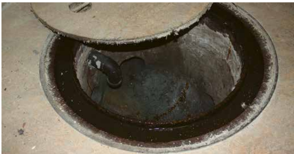
Figure 6.57 : Bouche de sol (puisard) de l'atelier au rez-de-chaussée.
