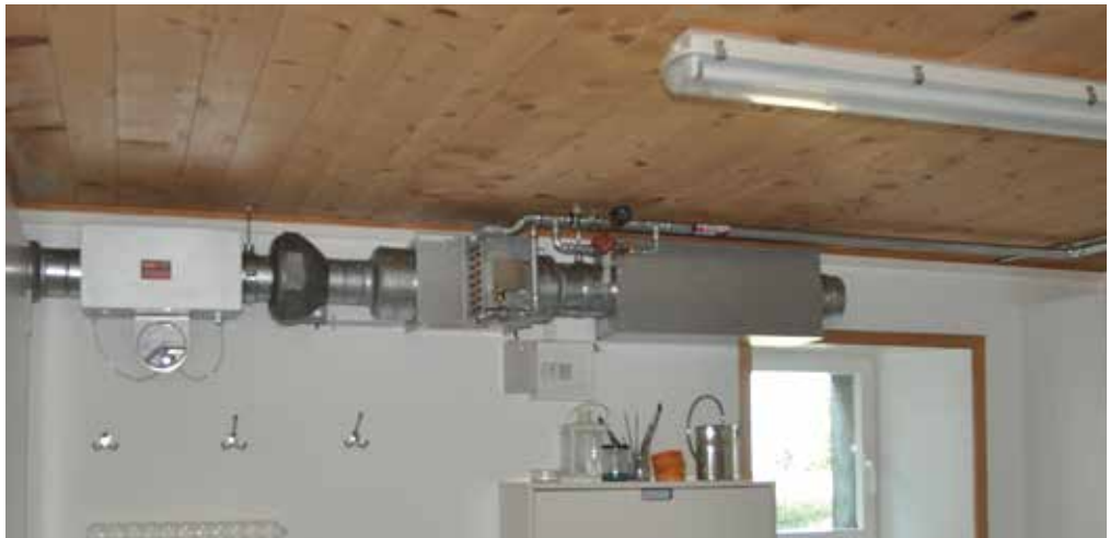
Figure 6.41 : Une ventilation par surpression a été installée dans la buanderie.
