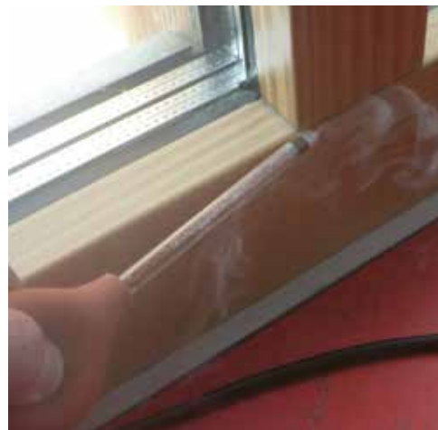
Figure 6.36: Des tubes détecteurs de courants d'air ont été employés pour repérer les flux d'air émanant de points de fuite caractéristiques (InfraBlow.Siegrist GmbH).
