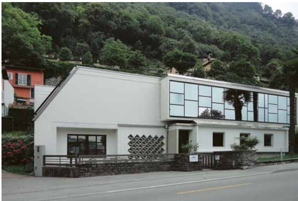
Figure 6.1 (en haut): Le bâtiment à deux étages présentait des défauts d'étanchéité au niveau du sol, ce qui a entraîné des valeurs accrues de radon, en particulier au rez-de- chaussée.
