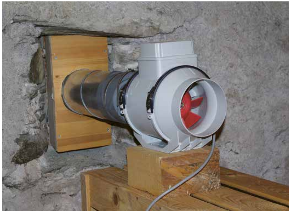
Figure 6.39 : Au moyen d'un ventilateur, l'air de la cave en terre battue est transporté à l'air libre. L'air à forte concentration de radon ne peut donc plus pénétrer dans les locaux d'habitation.
