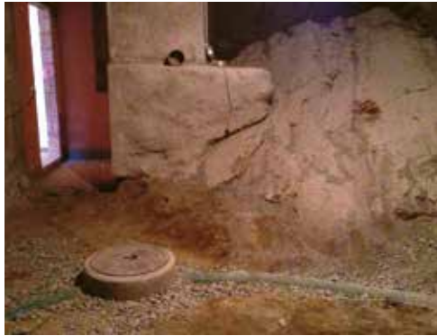
Figure 6.26 (à gauche): Puisard et tuyau de drainage: à l'arrière, on aperçoit la roche apparente.
