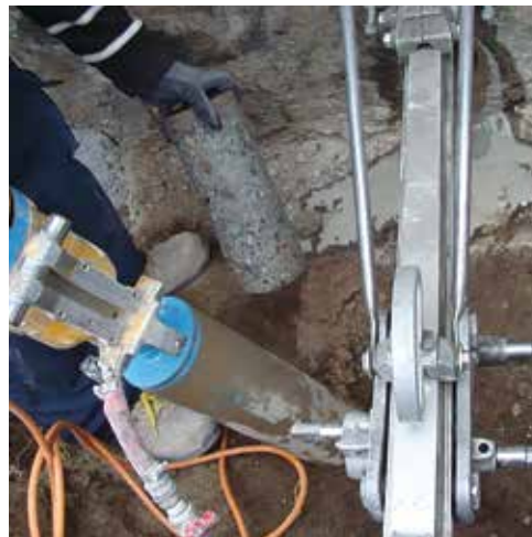
Figura 6.4: Per il pozzo radon esterno è stato eseguito un carotaggio sotto l'edificio.
