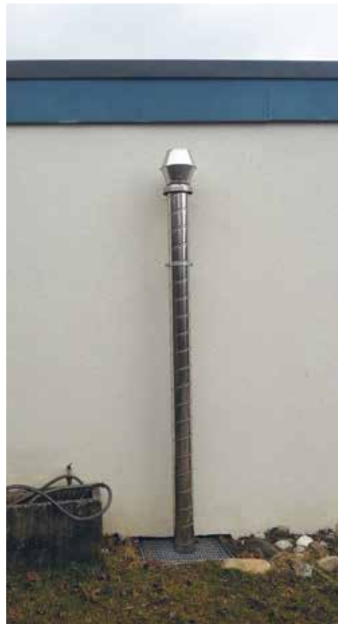
Figura 6.65: Nel vespazio è stato installato un impianto di aspirazione.
