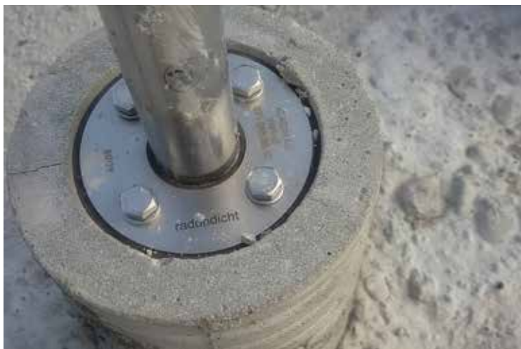
Figura 6.100: Una condotta passante ermetica al radon.
