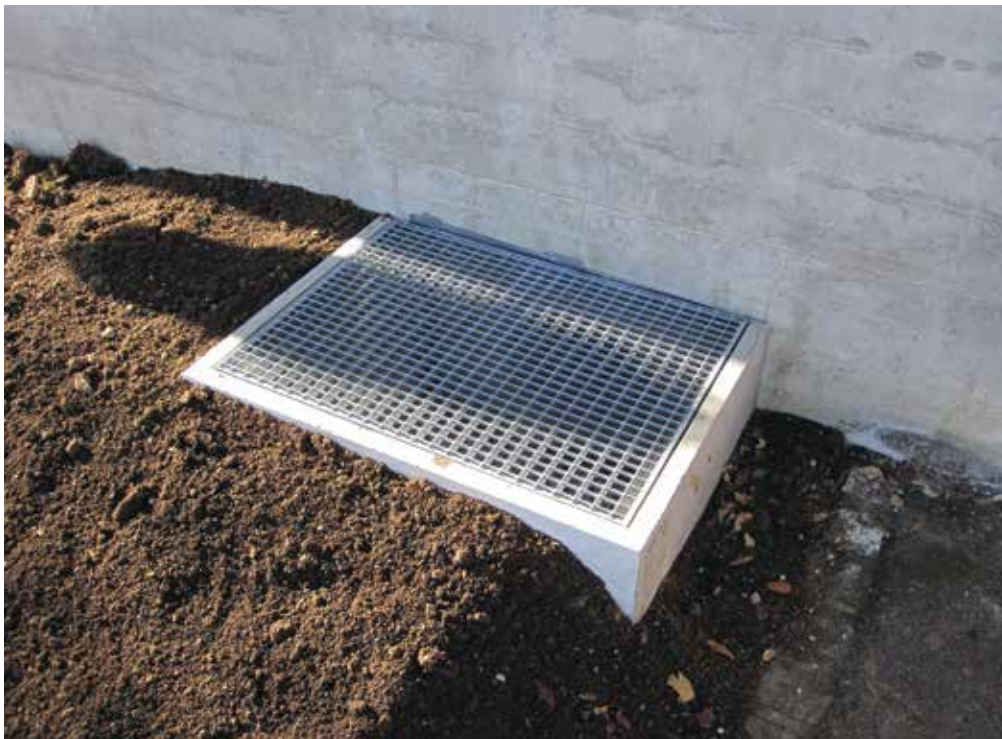
Figura 6.50: Invece di essere espulsa grazie ad un tubo portato a tetto l'aria contaminata raggiunge l'esterno attraverso questa griglia. Durante il funzionamento, la concentrazione radon nelle vicinanze della griglia è di circa 4000 Bq/m 3 .
