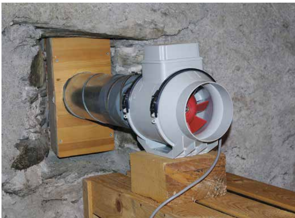
Figura 6.39: Mediante l'ausilio di un ventilatore l'aria del piano interrato viene trasportata all'esterno. L'aria con un'elevata concentrazione di radon non può quindi più concentrarsi all'interno dell'edificio.
