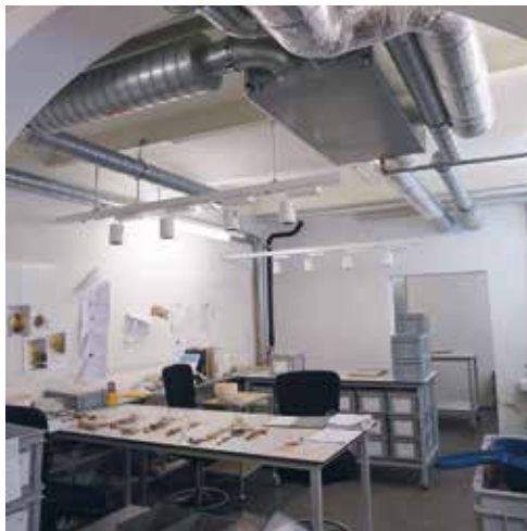
Figura 6.73: Gli spazi presenti al piano interrato vengono parzialmente utilizzati come locali di lavoro (a sinistra). A destra si può osservare il punto di estrazione della ventilazione meccanica installata.
