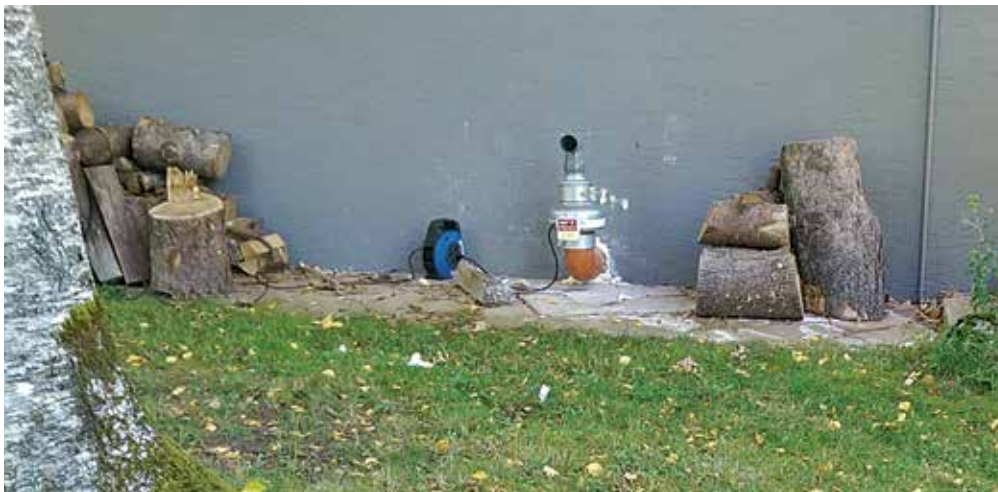
Figura 6.55: Installazione provvisoria del pozzo radon.
