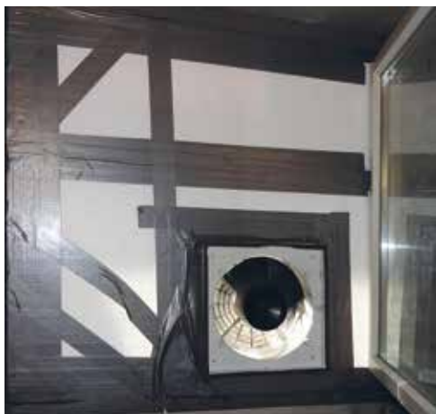
Figura 6.8 (sinistra): I primi tentativi sono stati eseguiti installando un ventilatore sulla finestra situata al piano interrato.
