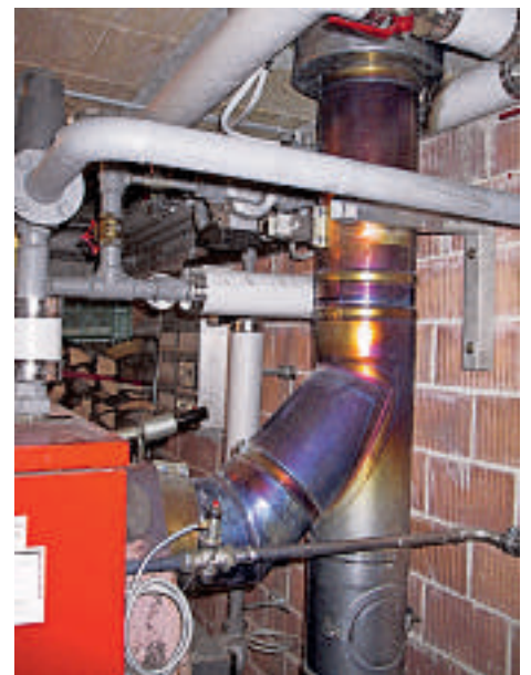
Farbveränderungen an Edelstahlkamin können zukünftig korrekt beurteilt werden.
