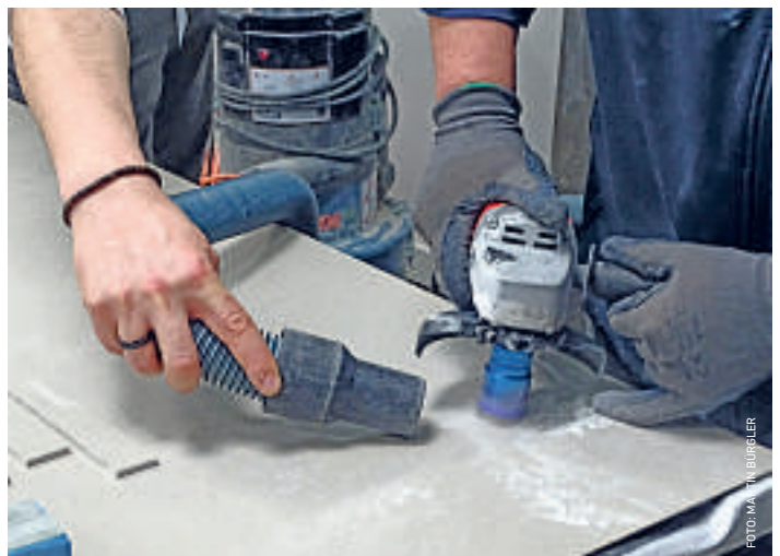
Die Bohrkronen, die Löcher und Aussparungen herausarbeitet, ist mit einem Diamantblatt bestückt.
